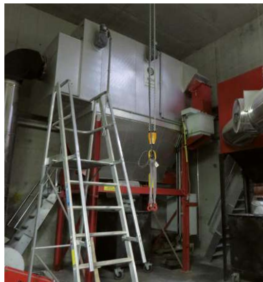
Figure 18 : Electrofiltre (Piscine Mallarmé - Besançon)
