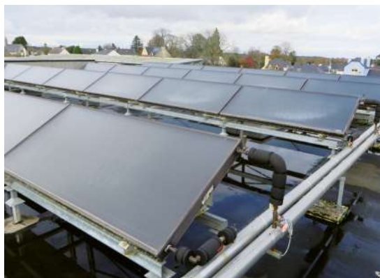
Figure 19 : Capteurs plans en toiture terrasse
