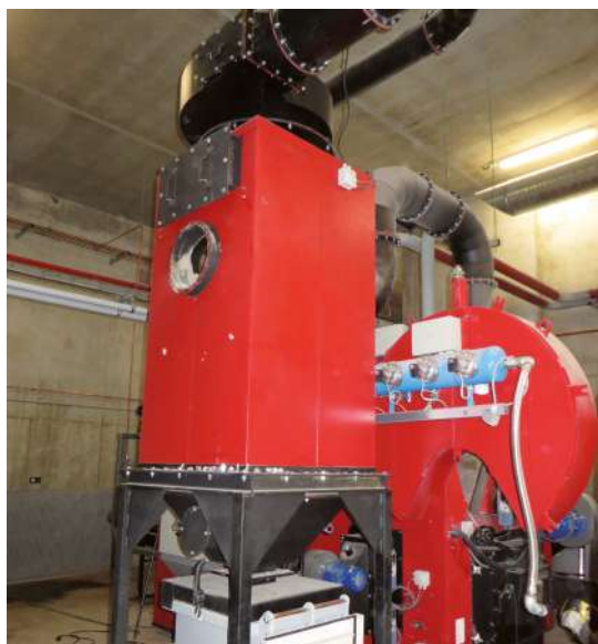
Figure 17 : Multicyclone (Centre aquatique de Libourne)
