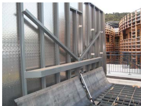
Trappe basculante Chaufferie à Levens (06)
