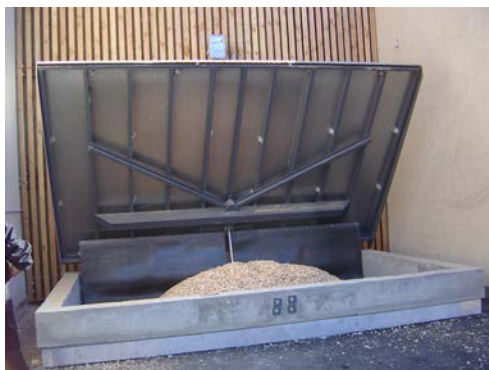
Chaufferie de l'Hôpital local de Volx 220 kW bois (04)
