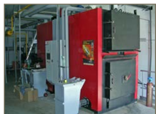
Chaufferie du Lycée du Muy 960 kW bois (83)
