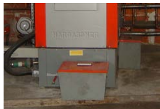
Chaufferie menuiserie Bérard 100 kW bois (05)
