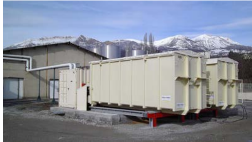
Chaufferie de la laiterie Sodiaal 150 kW bois (05)
